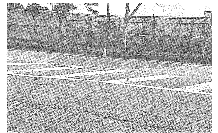
訓練用道路の陥没とひび割れ
